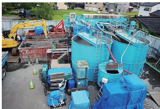
写真-3 プラント全景
