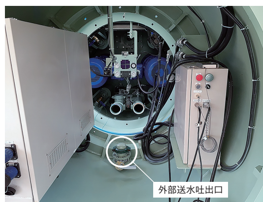
写真-6 外部送水機構
