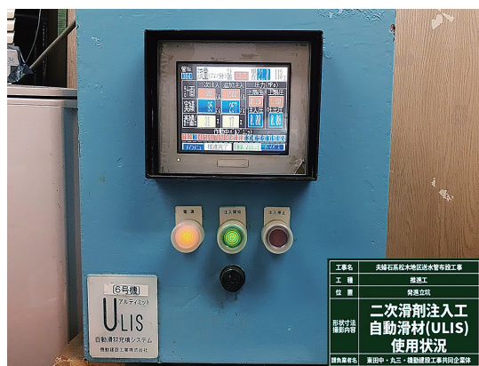
写真－2 自動滑材注入システム（ULIS）
