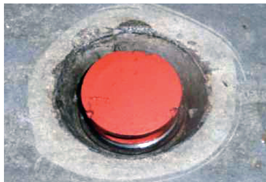
写真-4 グラウトホールキャップ
