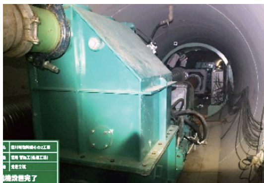
写真-6 自動土砂圧送システム
