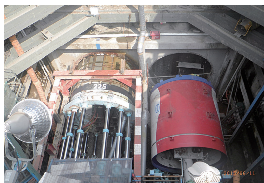
写真-6 アウトレット施工（ジャカルタ、チリウン川放水路プロジェクト）
