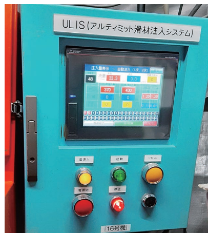
写真-2 ULIS制御盤
