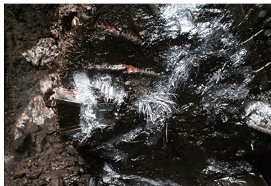
写真-6 面板閉塞状況
