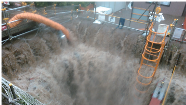
写真-1 ゲリラ豪雨で雨水が流入する立坑
