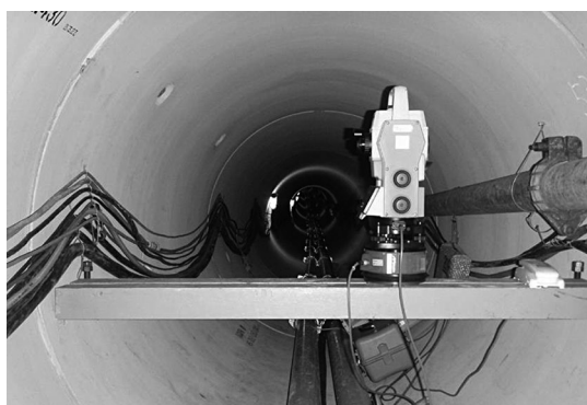
写真-6 管内自動測量機設置例
