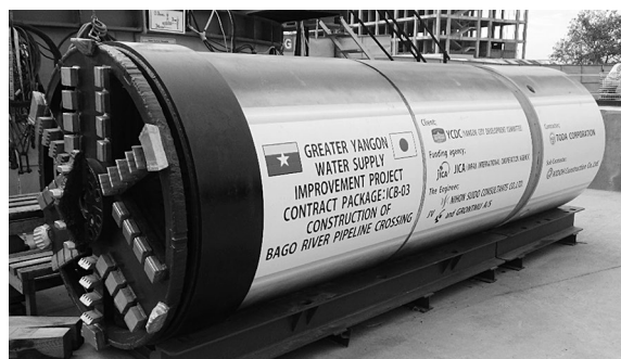
写真－1 泥水式掘進機全景
