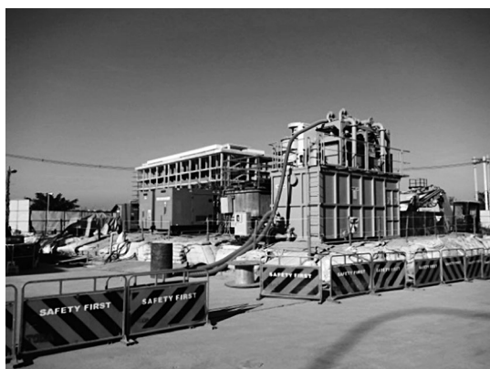
写真－10 発進基地全景（プラント設備）
