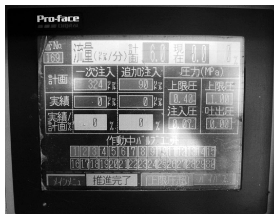
写真-2 ULIS 制御盤モニタ画面
