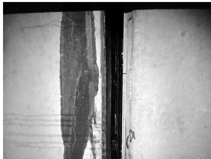
写真-3 ゴム輪のはみ出し
