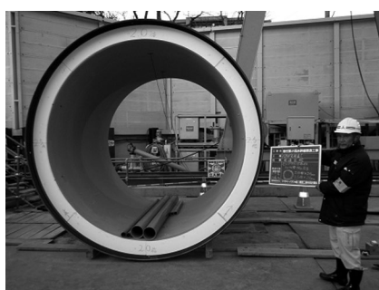
写真－4 センブラリング設置状況
